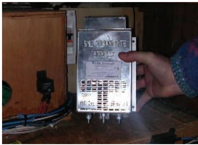
A sinistra: relè di parallelo prima della sostituzione con l'alternatore elettronico
