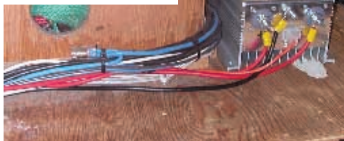
A destra: Alternatore elettronico dopo la sostituzione del relè
