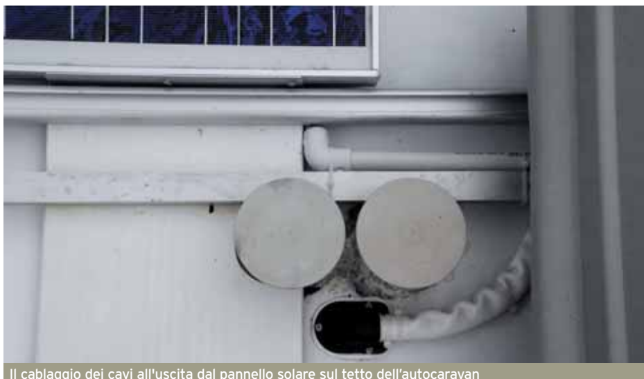
Il cablaggio dei cavi all'uscita dal pannello solare sul tetto dell'autocaravan
